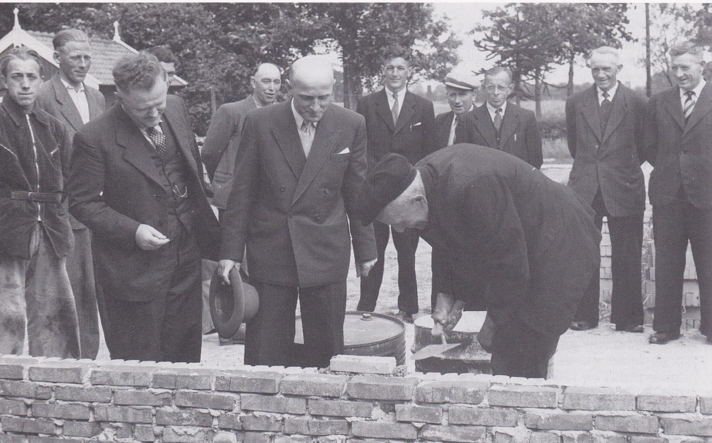
Bouw van de Chr. school te Ypelo. Links: J. Eertink, aannemer Brunnenkreef, 't hoofd B.J. Schrotten, G.J. Ooms (metselend), midden achter: B.J. Hommers, H. Lankamp, A. Nijland, J. ter Keurs, W. Rotman.
